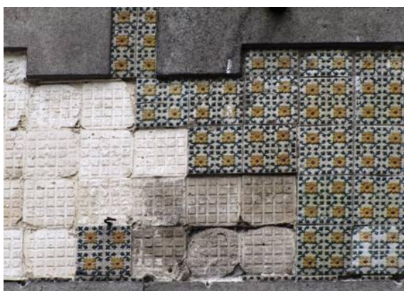
Figura 3: Painel de azulejos com falta de azulejos.
