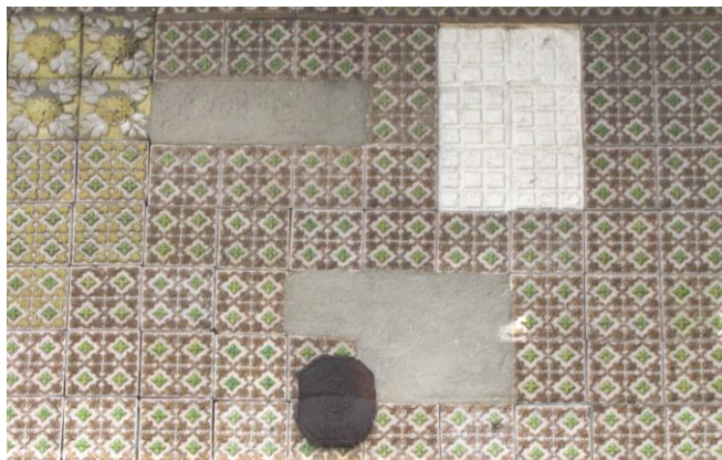
Figura 2: Painel de azulejos com falta de azulejos e preenchimento com argamassas de cimento.
