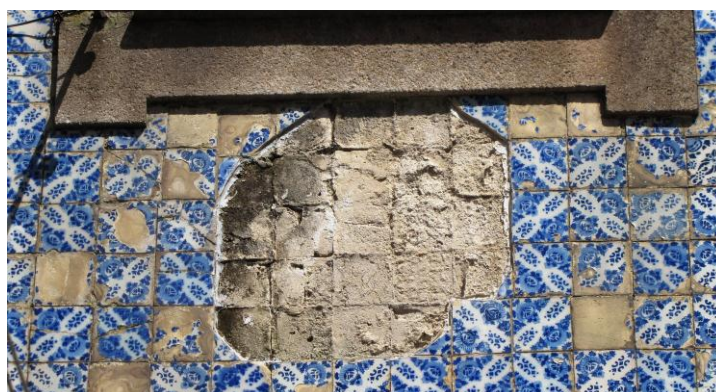
Figura 4: Painel de azulejos com falta de azulejos e com assentamento deficiente.
